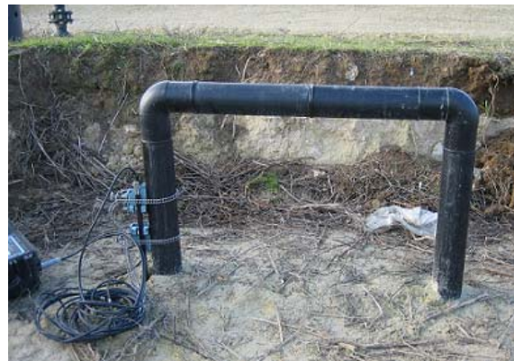
Débitmètre à ultrasons sur le collecteur principal
