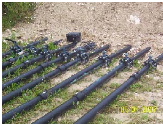
Drains d'alimentation du dispositif N°2 (8 chambres)
